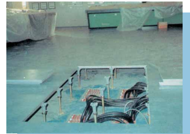
▲制御室 床貫通
