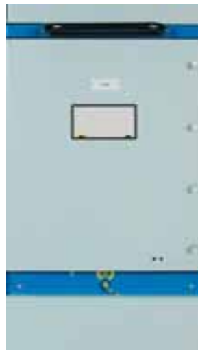
遮断器区画面
